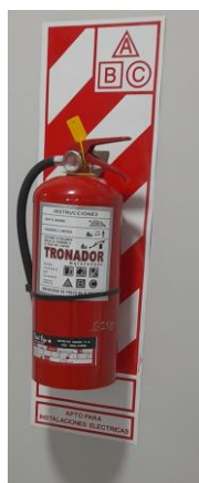
Nota. Imagen de un extinguidor de tipo ABC presente en el edificio de Delegación.
