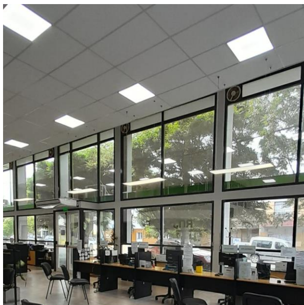
Nota. Imagen de los extractores de aire del edificio de Delegación.
