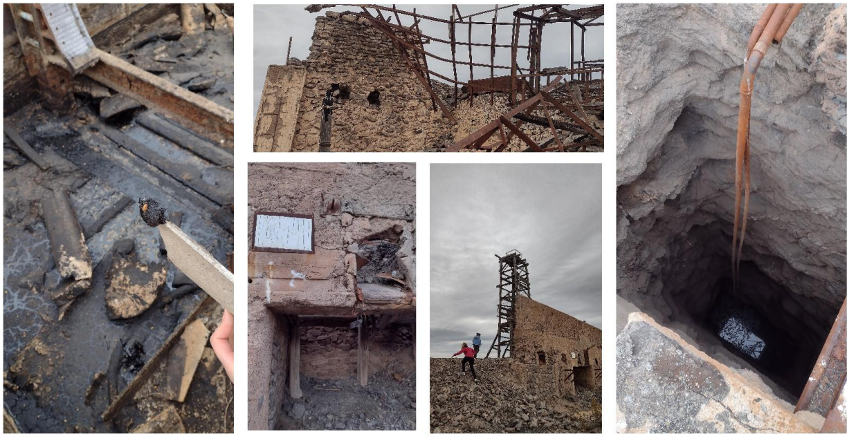
Figura 3: Estado de la infraestructura del lugar, se hallaron restos de alquitrán (foto costado izquierdo) y menas mineras expuestas sin ningún tipo de delimitación (foto costado derecho)
