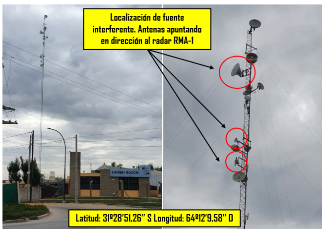
Figura 10. Localización de una fuente de interferencia en una dirección acimutal específica.
