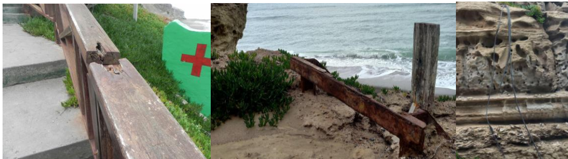
Figura 21: Infraestructura deteriorada. (Autor: Castillo Aluminé)
