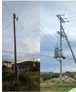
Figura 37: Servicio de energía eléctrica. (Autor: Castillo Aluminé)
