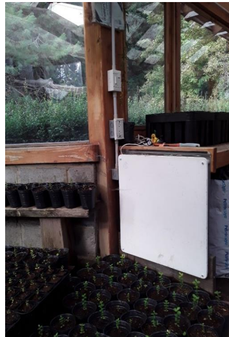
Sistema de calefacción eléctrica
