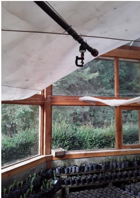
Sistema de riego aéreo
