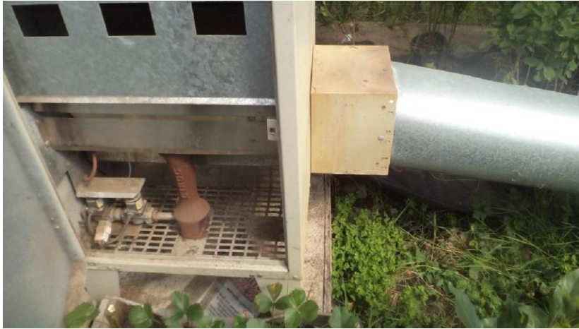
Figura 14. Vista lateral del generador y tubo que distribuye el calor
