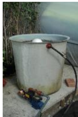
Figura 16. Tanque de reserva
