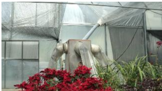
Figura 12. Vista frontal del generador y mangas de polietileno.
