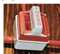
Sirena de la alarma de incendios.
