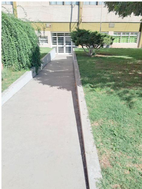
Rampa de Ingreso por Garita, usada usualmente por el personal. En días de lluvia el hospital se inunda por este desnivel. Las ventanas que se aprecian corresponden al área administrativa y dirección. Este ingreso conecta con un pasillo de escasos metros al Hall de ingreso.
