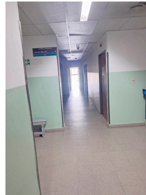
Imagen del pasillo a los cuartos de internación y office de enfermería. Se vuelve a observar la estrechez de los mismos para circular con camillas, y la escasa iluminación natural.
