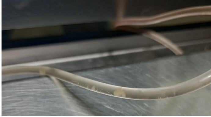
Imagen 8. Se puede observar sedimento en la línea de drenaje cerrado. Nota: Elaboración propia
