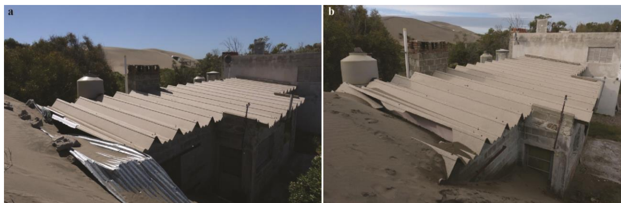
Figura 7.20. Detalle de la misma casa de las fotografías anteriores (fig. 7.20) donde se puede observar como avanza la duna por el techo de la casa y cómo va cubriendo la puerta y la parte lateral entre los años 2016 (a) y 2017 (b). El crecimiento de la duna es tanto horizontal como vertical, más este último una vez que se topa con la construcción.
