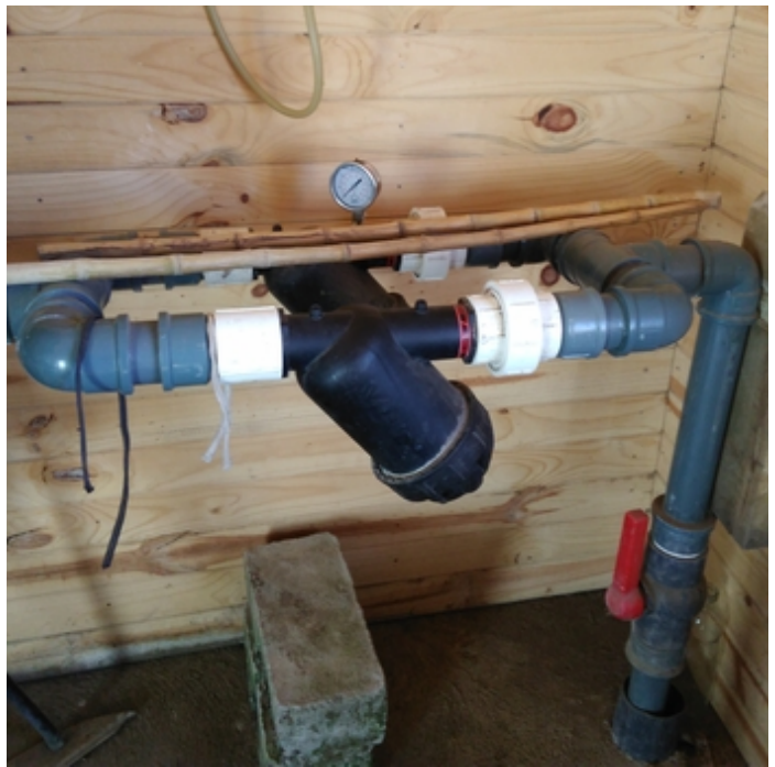
Figura 15: Filtros y manómetro.
