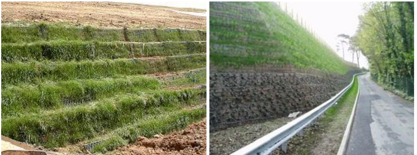
Figura 33: Sistema Terramesh. Está formado por una malla hexagonal de doble torsión asociados a una estructura de gaviones. Permite el desarrollo de la vegetación y está formado por materiales permeables. Fuente: https://www.maccaferri.com/br/es/productos/terramesh/ .
