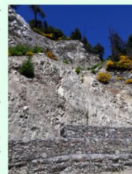
Fig. 2: Talud en Colonia Suiza
