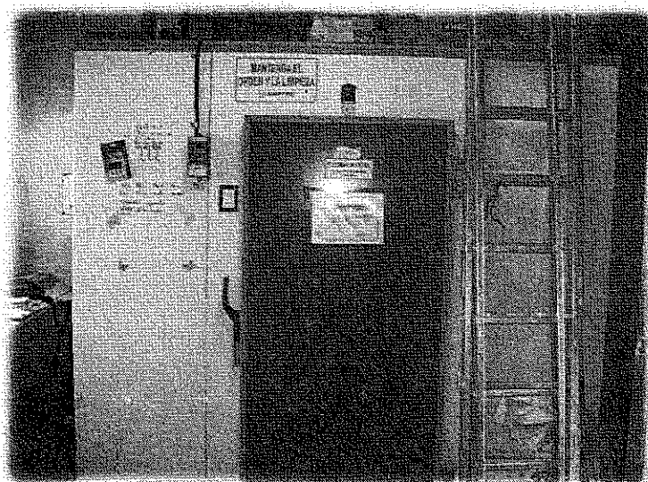
Fotografía 5. Cámara de frío en la EEA INTA Bariloche
