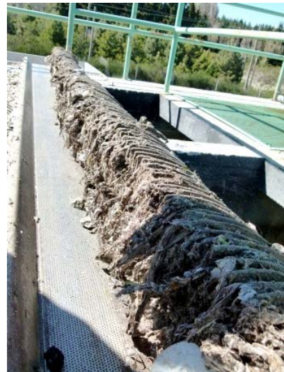
Figura N° 4 Tamiz en el desarenador. Fuente. Imagen propia
