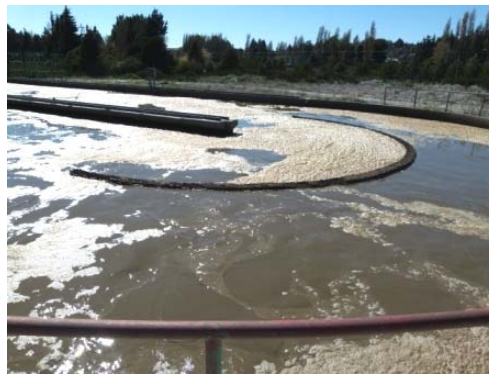
Figura N° 7 Vista Reactor biológico Fuente: imagen propia
