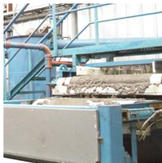
Figura N°23 Filtros de banda: Proceso de deshidratación de lodos. Fuente: imagen propia
