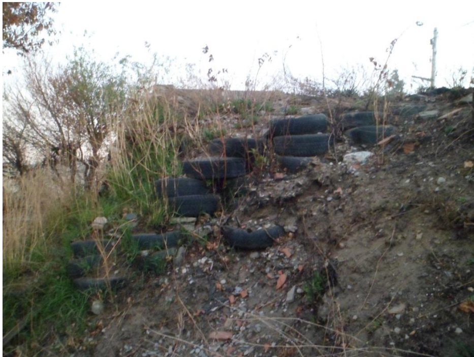
Figura 44: Neumáticos estabilizando una casa. Fuente: imagen propia.
