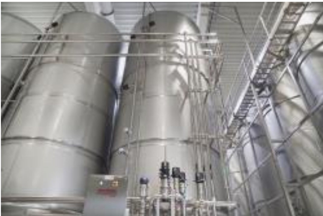
Figura 12: piletas donde se realiza el proceso de fermentación del jugo.
