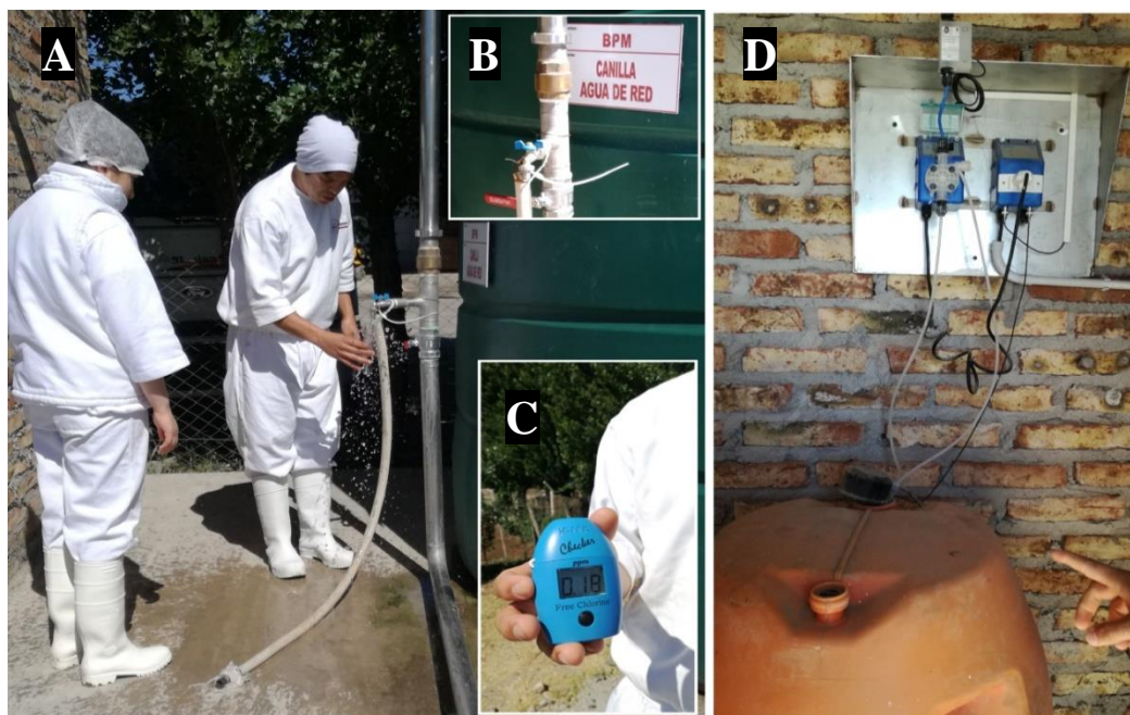
Figura 21 – A).Personal del frigorífico tomando muestra de la canilla. B).Canilla de agua de red de donde se toma la muestra para analizar. C).Colorímetro Cloro Libre Digital Hanna checker , con el resultado de la muestra. D).Bomba de cloro. Fuente propia.
