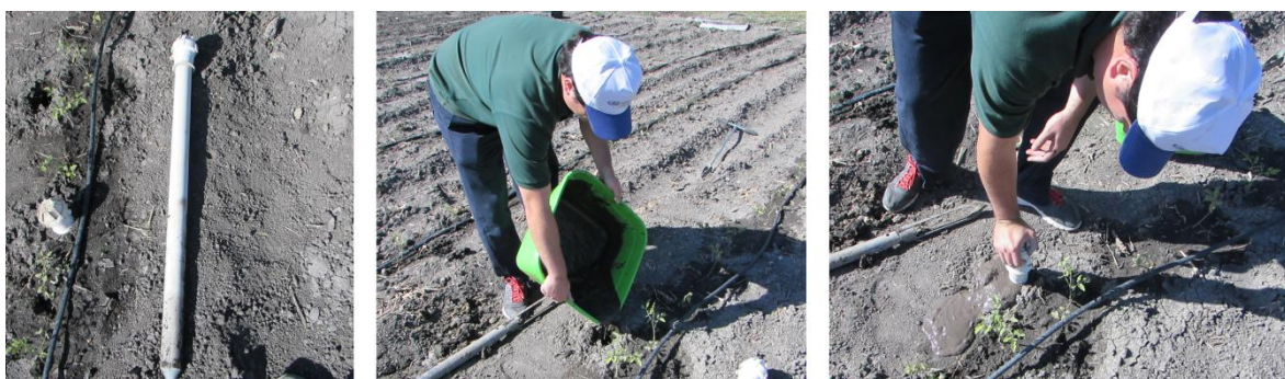
Figura 16: Secuencia de instalación de la sonda FDR.
