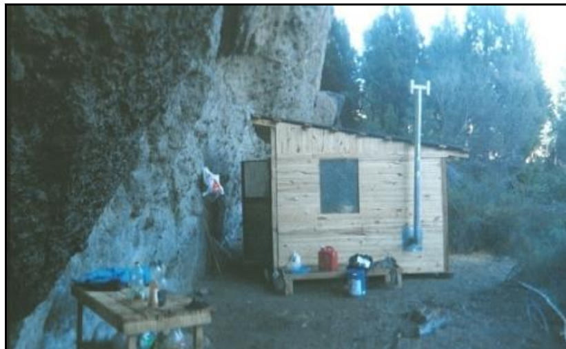
Sitio probable de contagio de un caso: casilla en Valle Encantado (Neuquén) utilizada por trabajadores forestales. Aberturas cerradas con nylon. En el interior se constató presencia de gran cantidad de excrementos de roedores distribuidos sobre piso, cuchetas, elementos de cocina, ropa, etc.
