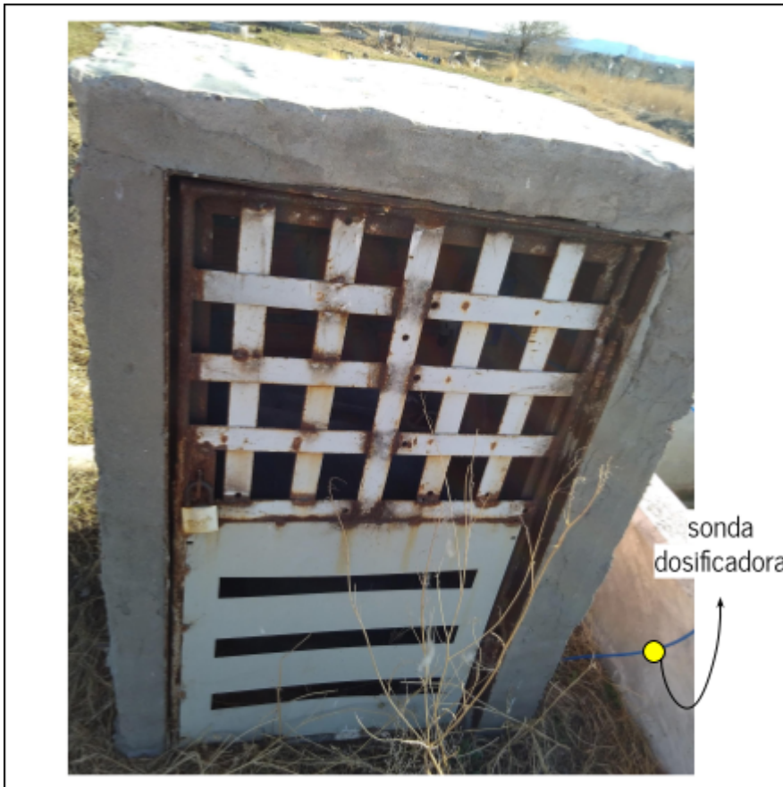
Figura 4.1.7.11: Infraestructura que contiene el dosificador. Fuente: propia.
