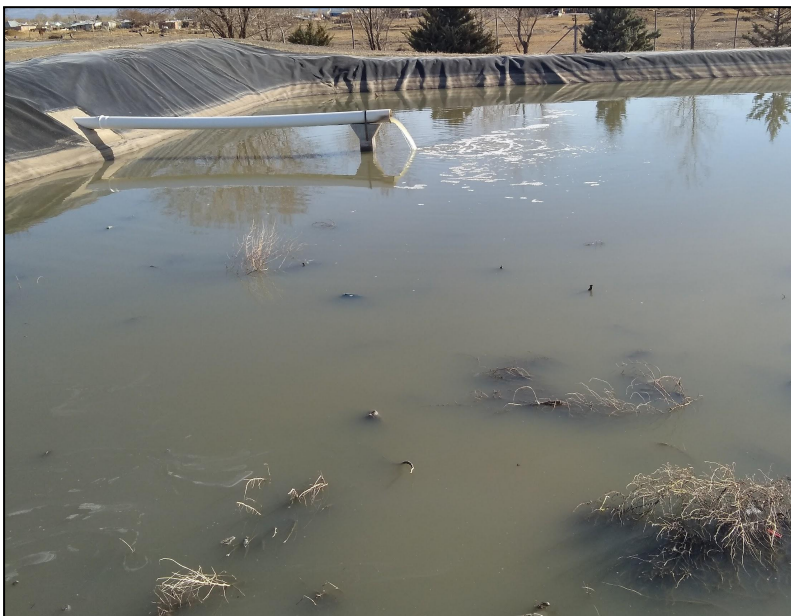
Figura 4.1.7.9: Laguna N° 1.1 presenta mayor caudal que las restantes lagunas y el olor es considerablemente más intenso. Fuente: propia.
