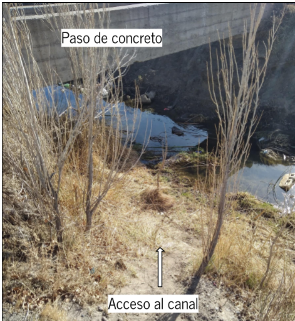
Figura 4.1.2.18: Paso de concreto a 150 m de la confluencia. Fuente: propia. Fecha de captura: 14/08/21.
