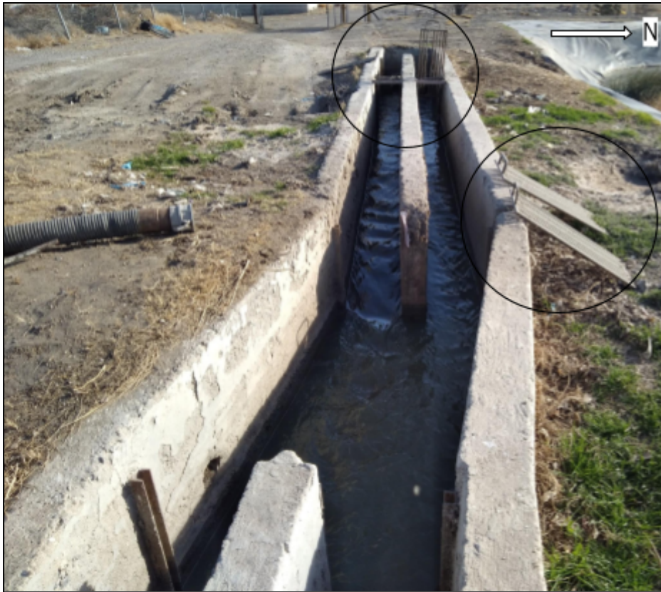
Figura 4.1.7.1: Cámara partidora donde se observan las rejas fuera del sitio adecuado (en negro). Fuente: propia.
