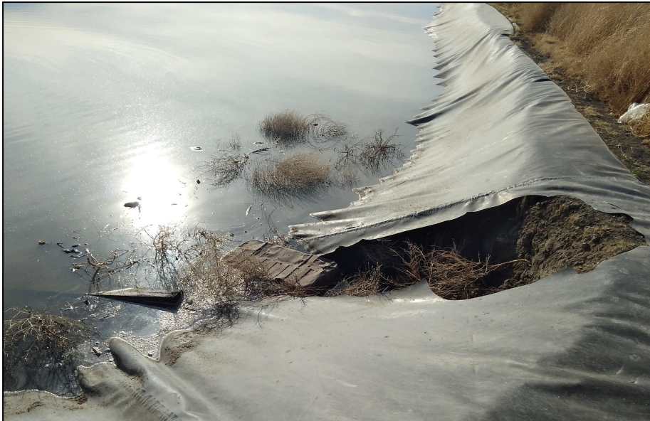
Figura 4.1.7.6: Ruptura de la membrana en el margen izquierdo más cercano al punto de recepción de afluentes de la laguna N°2. Fuente: propia.
