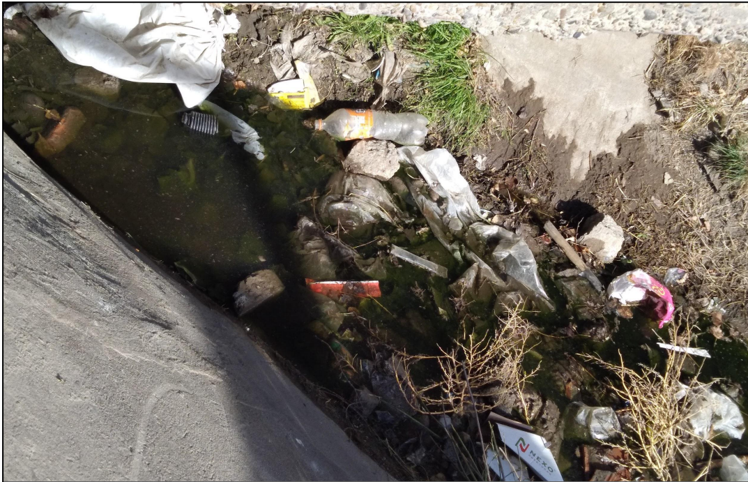
Figura 4.1.2.16: Residuos y agua estancada en el "Colector 2" hacia el oeste del puente que divide el colector en permanente e intermitente. Se presenta seco cuando no hay precipitaciones. Fuente: propia. Fecha de captura: 14/08/21.
