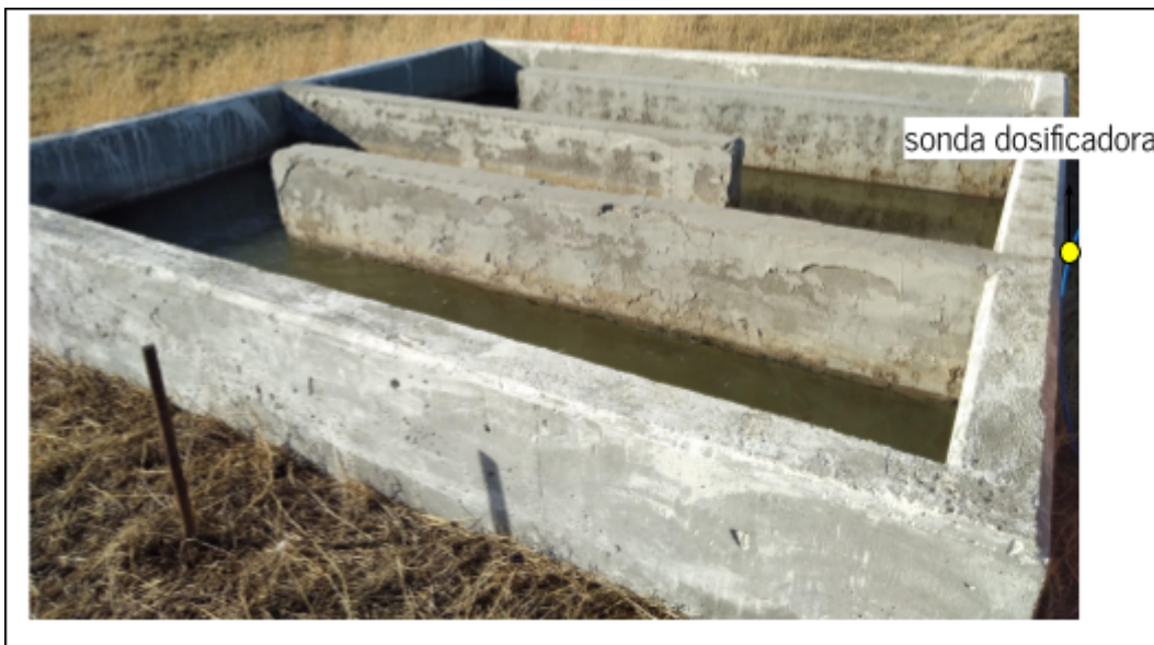
Figura 4.1.7.12: Cámara de contacto inmediatamente ubicada al lado del dosificador. Fuente: propia.
