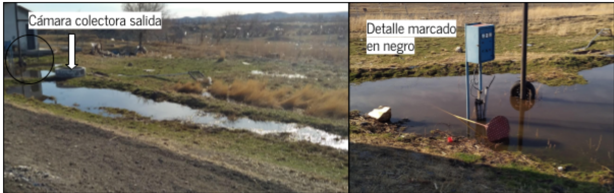
Figura 4.1.7.10: Charco de agua situado alrededor de la cámara colectora de salida. Fuente: propia.
