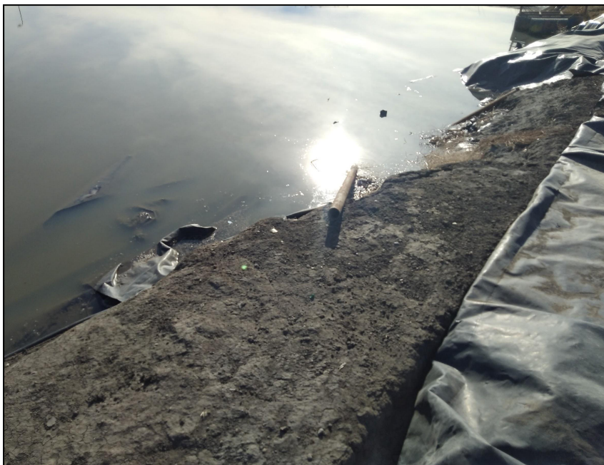
Figura 4.1.7.7: Ruptura de la membrana en el margen izquierdo central de la laguna N°2. Se observa sólo el talud reparado. Fuente: propia.
