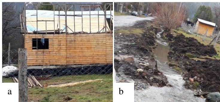
Figura 9: Características de la urbanización en el sitio I a) Viviendas elevadas el nivel del terreno, b) Desagües rudimentarios que desembocan en el arroyo. Fuente: propia.
