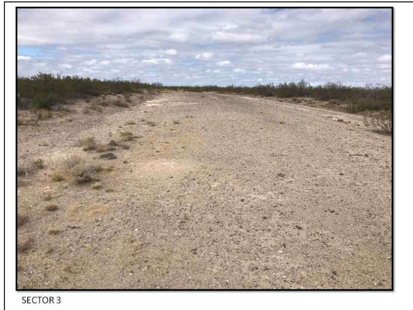
Figura 84: Sector 3 con degradación.
