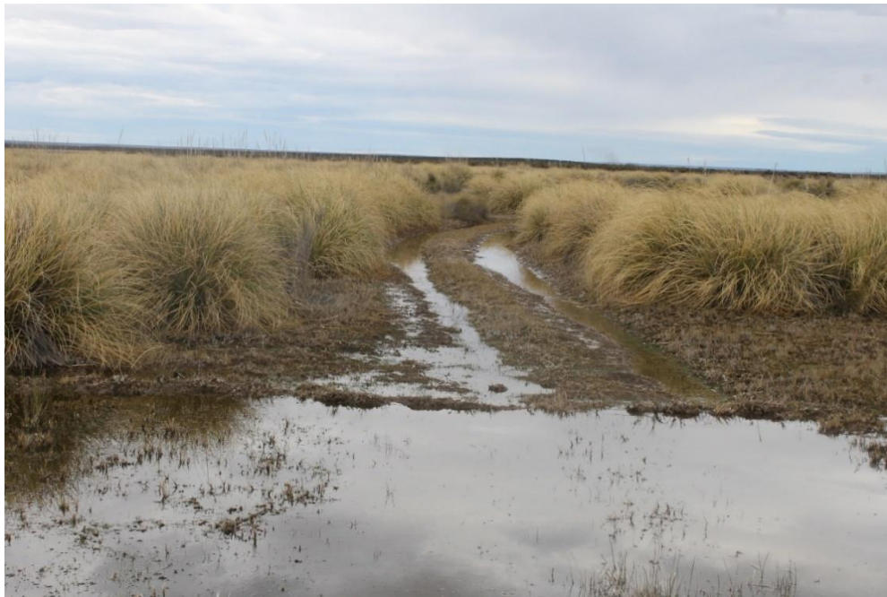
Figura 40: Camino de acceso a la laguna Curi-Có totalmente anegado Fotografía: Ochoa, 2019.
