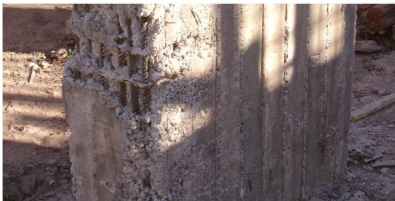
Imagen: Nido de abeja (o avisperos). Defectos en el colado del hormigón. Incapacidad de cubrir el elemento.
