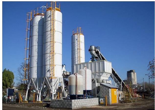
Imagen: Silo vertical de acopio de cemento.
